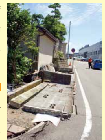
倒壊したブロック塀 (H19新潟中越沖地震)
